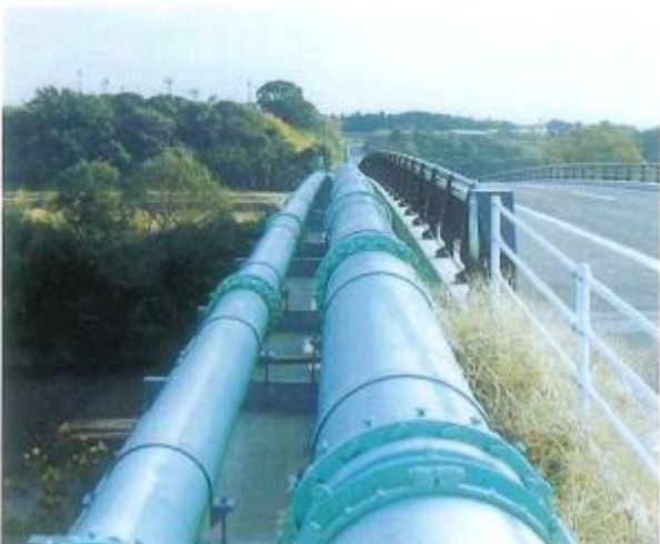
河川を横断する水管橋
