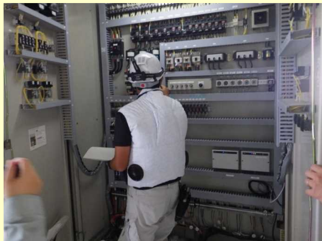
電気設備点検
