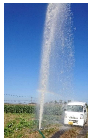
給水栓破損による漏水
