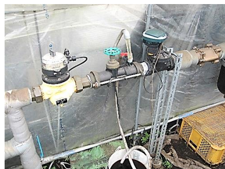
（定流量停止弁、液肥混入器、散水タイマーの組み合わせ）
