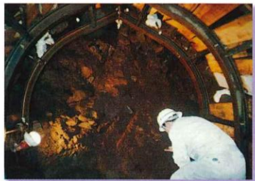
整備が進む畑かん施設導水路
